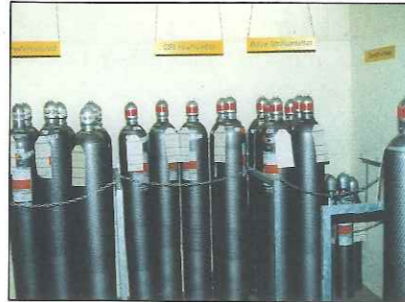
Lagerraum für Flaschengase: strenge Regeln sorgen für Sicherheit
